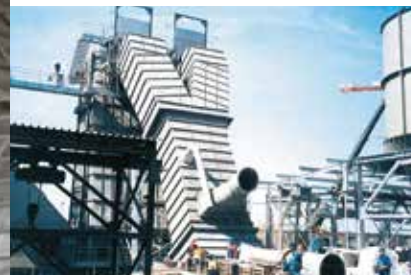
Kalcret als beschermlaag in een ontstoffingsleiding van een klinkerkoeler
